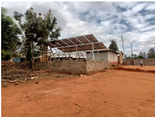
Neue Solaranlage für den Strombedarf
